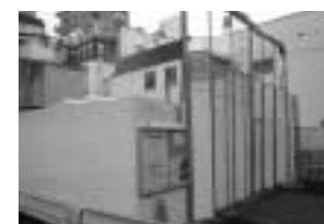
▲エレベーター用通路の工事が始まった中野新橋駅裏の区道
